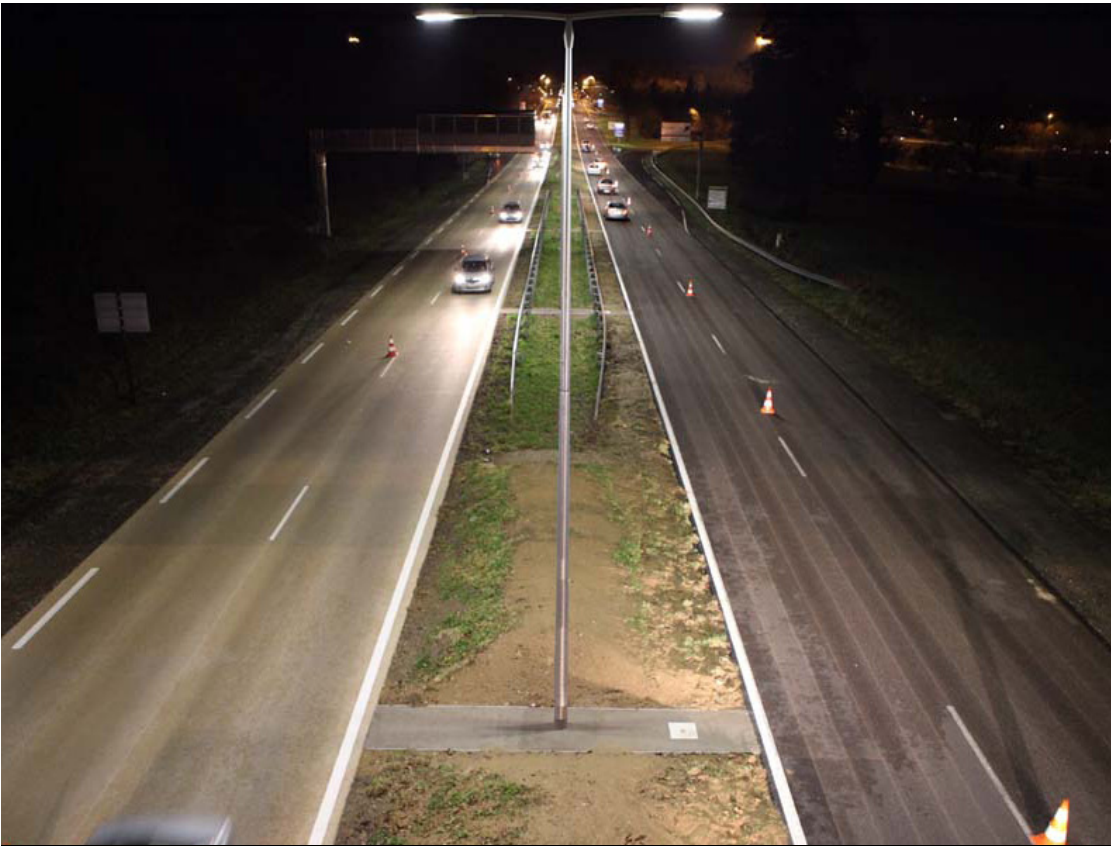
En zones urbanisées, l'éclairage public des grands axes doit respecter des niveaux de luminance ou d'éclairement de la norme EN 13-201 et ses critères d'uniformité.
